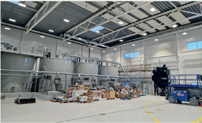
Inne i hallen er tanker og blandedanlegg i ferd med å komme på plass.
